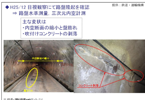
図-2 先進導坑で発生した変状
