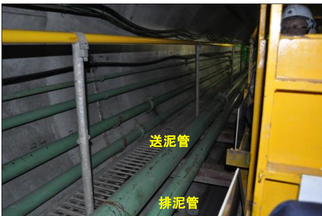
写真-5 送泥管と排泥管
