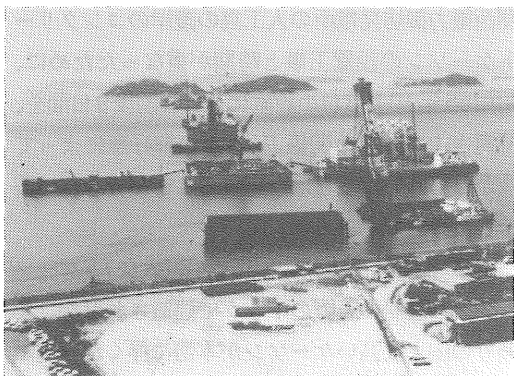
写真3 7Aケーソン根固めモルタル注入状況 手前は番の州高架橋1P鋼管杭打設
